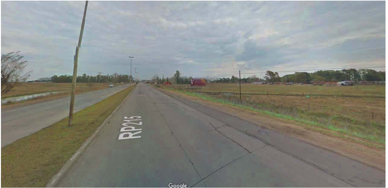
Imagen 3. Deterioro en losas R.P. Nº 215, Partidos de Brandsen y La Plata.
