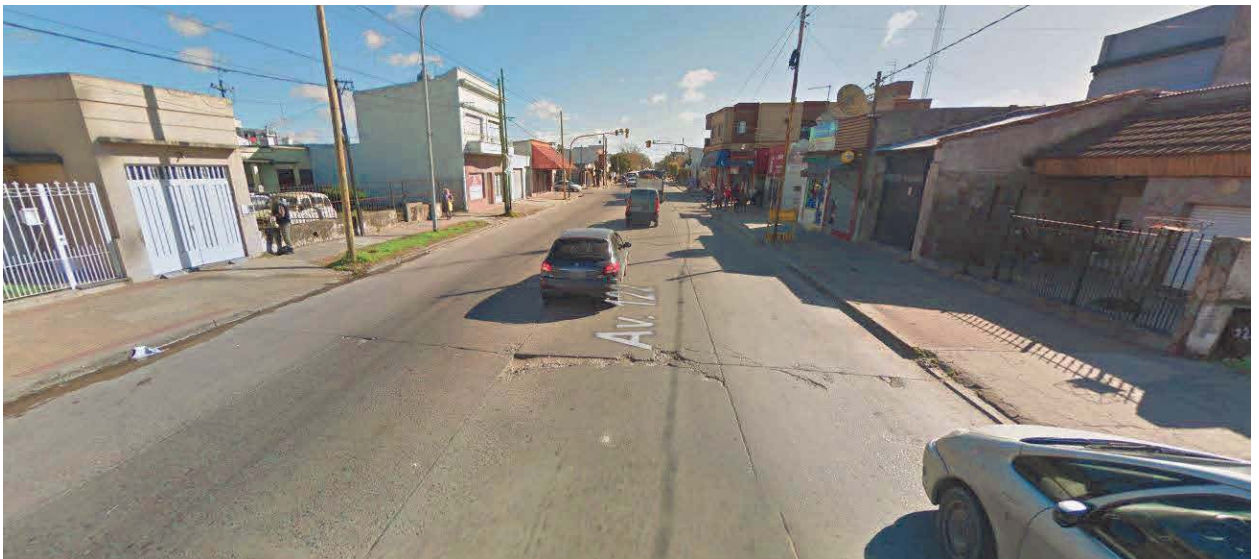
Imagen 4. Deterioro en losas Cno. Sec. 055-13, Partidos de Berisso y La Plata.
